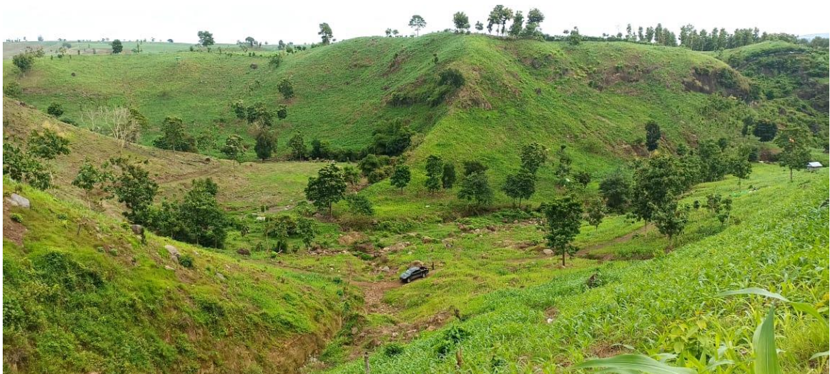
Gambar 8. Kondisi lereng bekas bencana longsor
